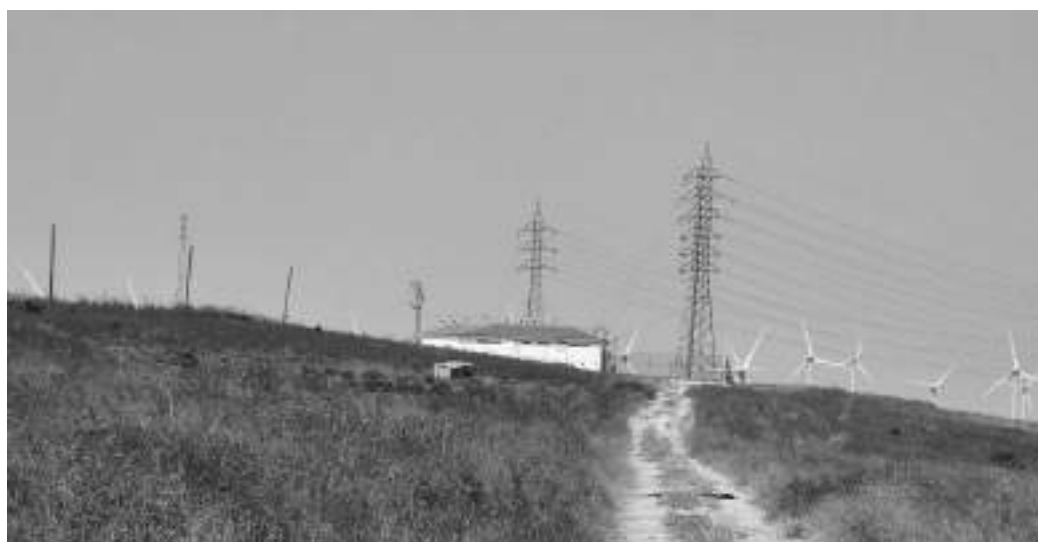
Fotografía 2. Subestación Eléctrica Transformadora "Atlanterra 66/20 kV", en el término municipal de Tarifa.
