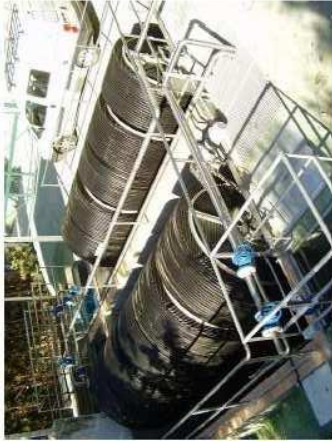
Detalle biodiscos B22 en tanque de hormigón
