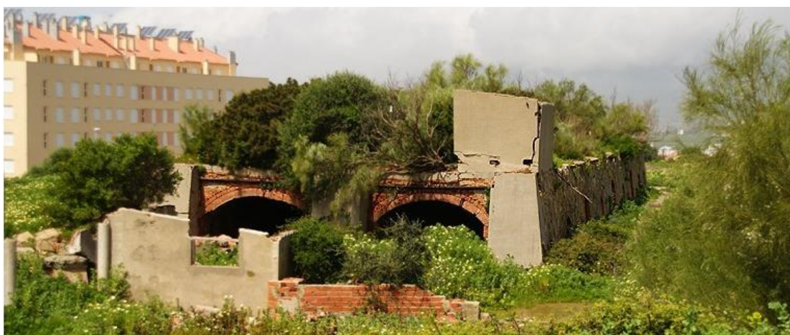
Antiguas construcciones en mal estado de conservación (A), (B) y (D).
