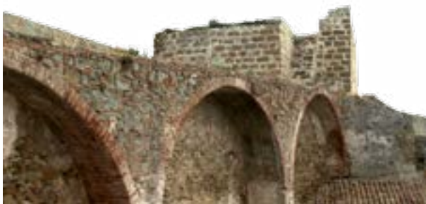
Arcos que fueron adosados para soportar el camino de ronda (APM)
