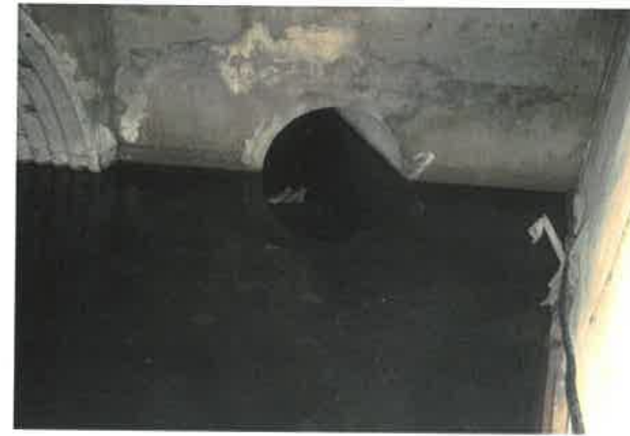
Tubería 1000 mm HA procedente del ramal Este que acomete a la arqueta P2 (*)
