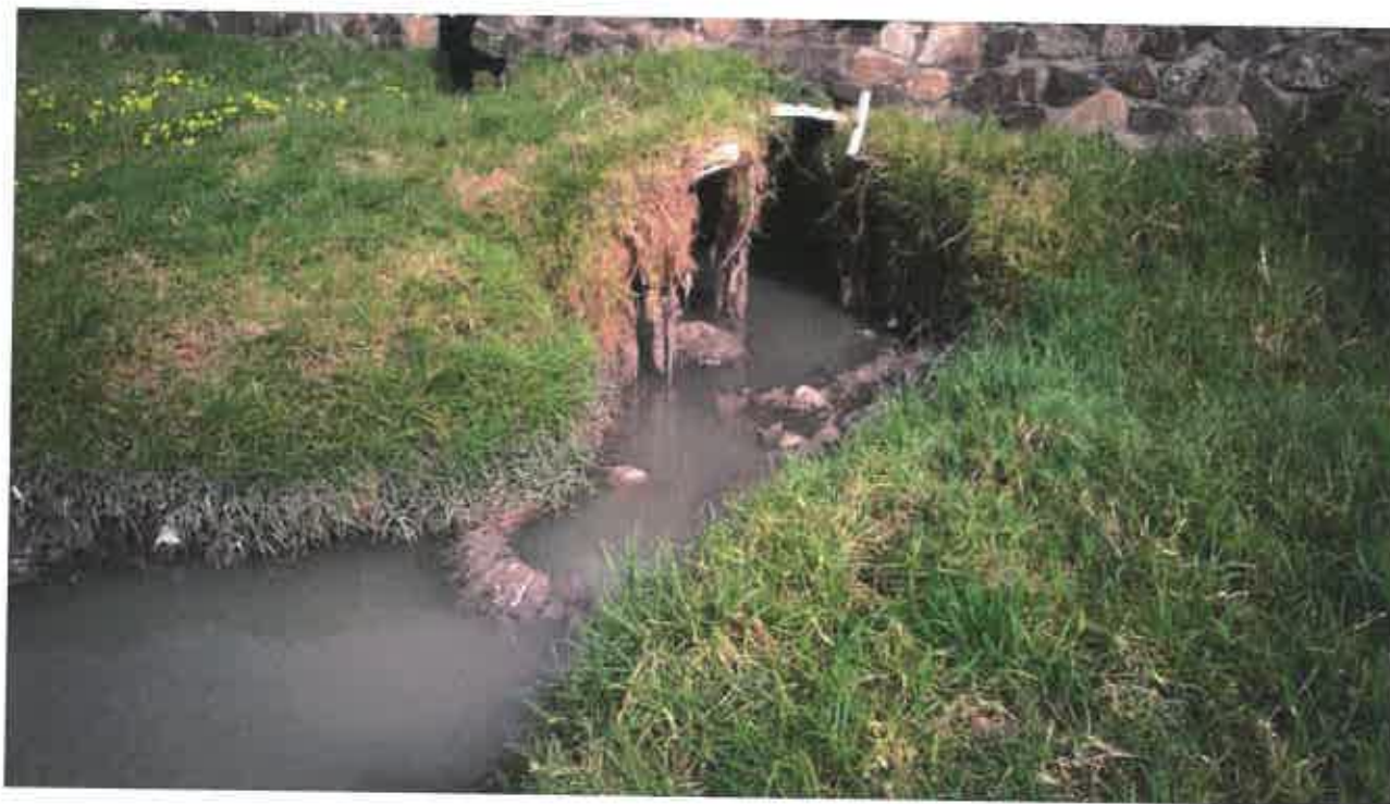
Imagen de la salida del tubo arco a la playa de Los lances (Paseo Marítimo)
