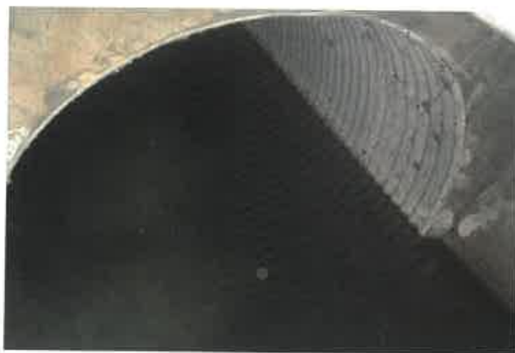
Tubería tipo arco que acomete a la arqueta P2 (*)
