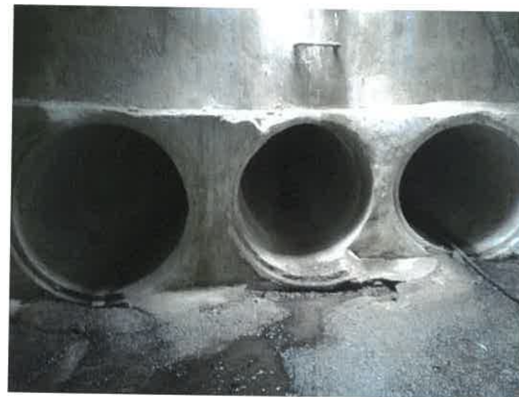
Tuberías HA 1000 mm que entran en la arqueta P3 (*).
