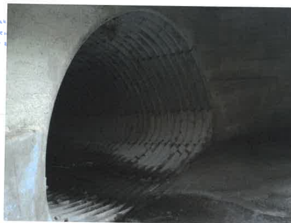
Tubería arco que sale de la arqueta P3 (*).
